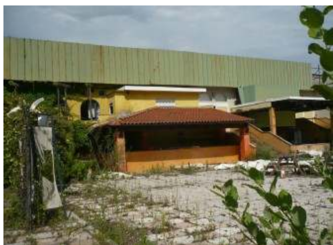
Un'eloquente immagine dell'attuale degrado del complesso
