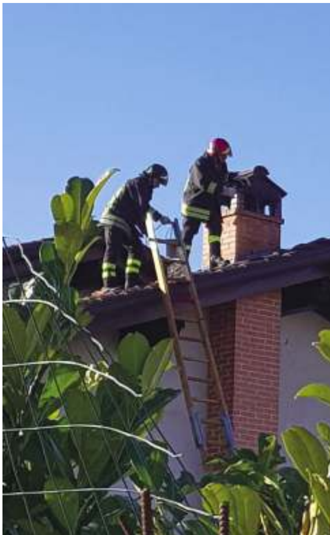
Intervento ieri a Ghemme dei vigili del fuoco del distaccamento volontario di Romagnano
